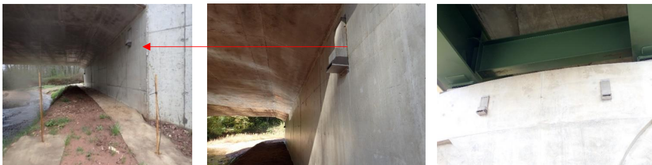
Exemple de gîtes artificiels dédiés aux chiroptères, aux abords de la Loyre et de la Corrèze
