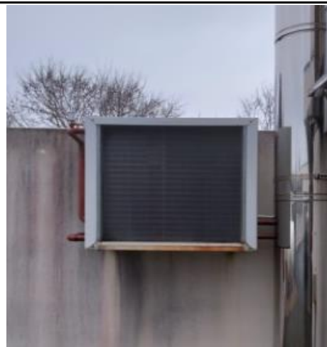
Dissipateur thermique solaire
