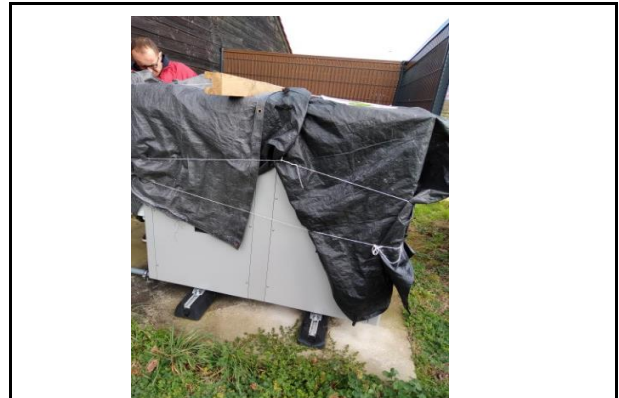
x2 pompes à chaleur 40 kW
