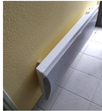
Radiateurs électriques salle d'activité
