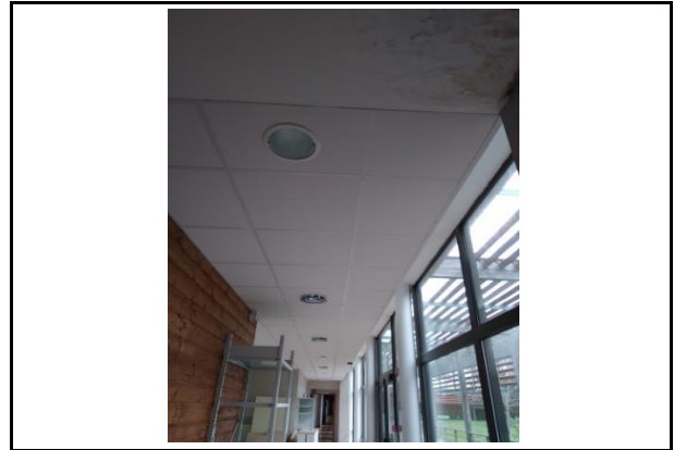
Circulations bâtiment Antioche - Infiltrations toiture terrasse
