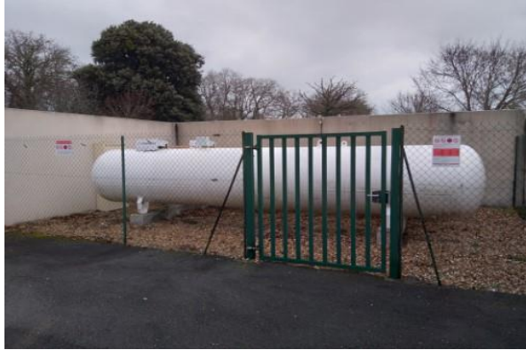
Stockage du propane
