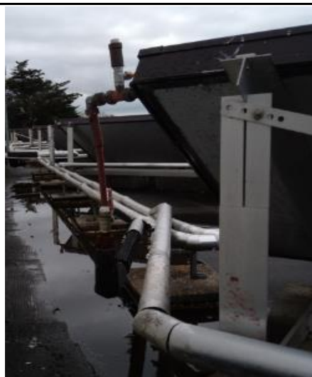
Panneaux solaire thermiques HS en toiture
