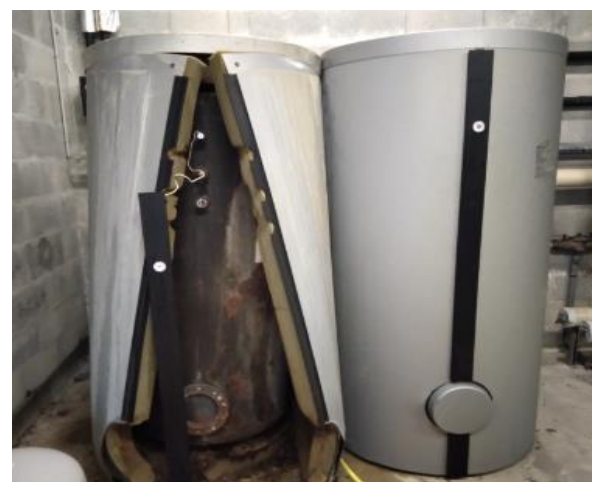
Ballon de stockages solaire HS
