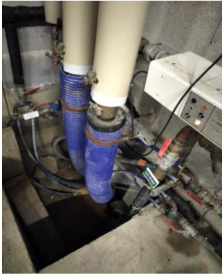
Départ vers sous-station
